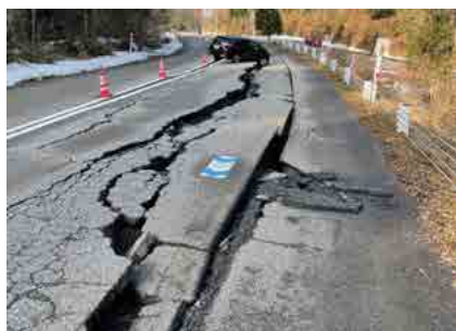
地震被害状況
