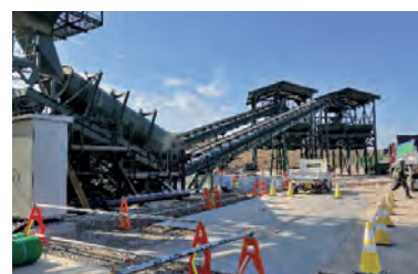
CSG製造プラント
