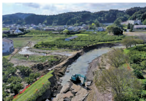
令和4年台風第15号による堤防決壊状況
