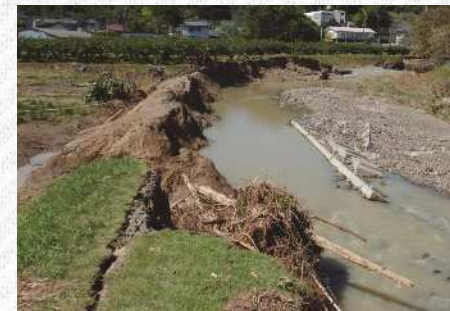
二級河川敷地川の破堤(磐田市敷地) ※右岸側の堤防が破堤し、背後地が浸水した。
