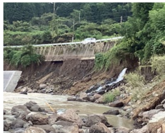
被災状況 (二級河川興津川 護岸決壊)
