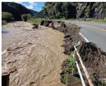
被災状況 ((主)袋井春野線 路肩決壊)
