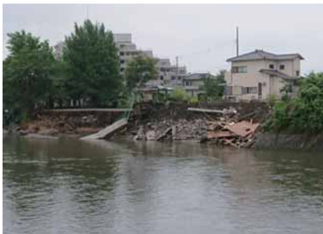
被災状況（黄瀬川 護岸決壊）
