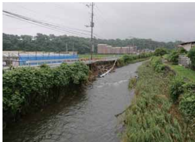
被災状況（桃沢川 護岸決壊）
