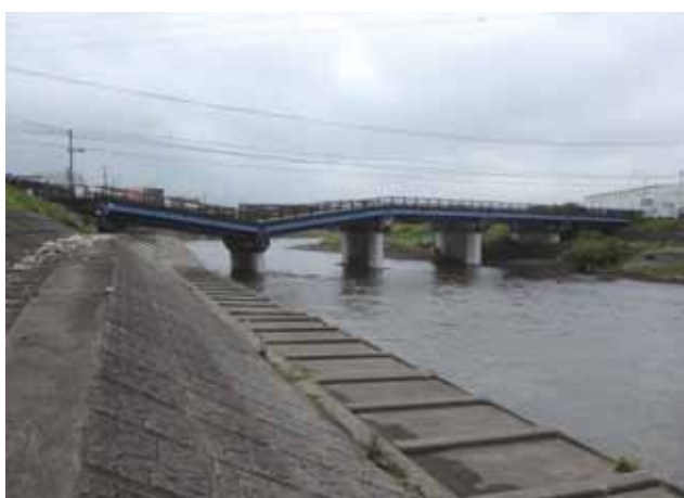
被災状況（黄瀬川大橋）
