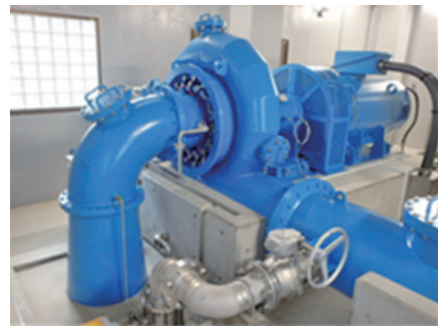
水車・発電機
