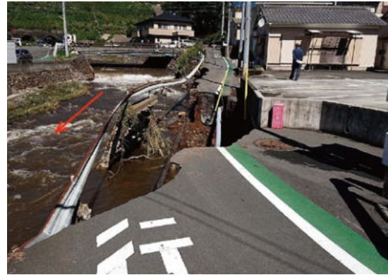
被災状況(来光川 護岸決壊)
