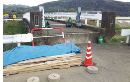
木山川に架かる橋の被災状況
