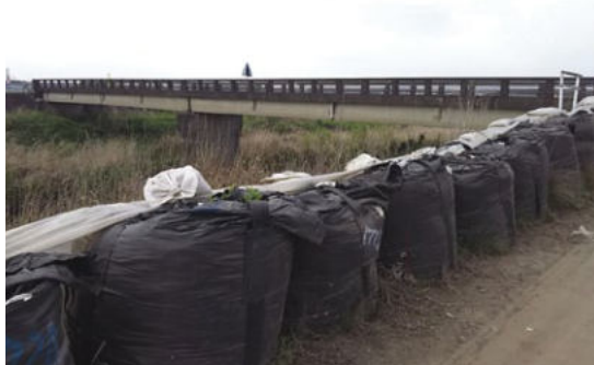
木山川の堤防沈下状況
